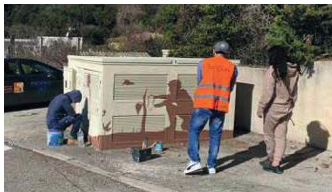
À l'occasion d'un chantier d'insertion avec le Groupe Bonjours Présence 30, des jeunes ont embelli un transformateur électrique situé chemin de Parignargues en le couvrant d'une fresque.
