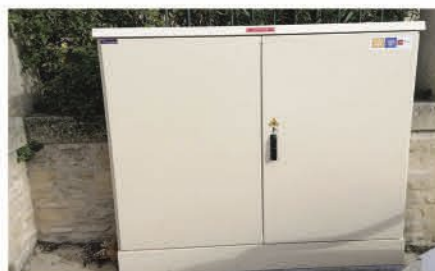
Fibre optique. Le réseau interne a été mis en place, en attente d'une dernière intervention de l'entreprise permettant le raccordement aux maisons.
